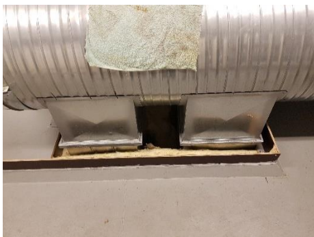
Kuva 98. Ilmanvaihtokoneesta on otettu kaksi haaraa alaspäin. Läpivienti on pyritty tiivistämään lasivillalla.
