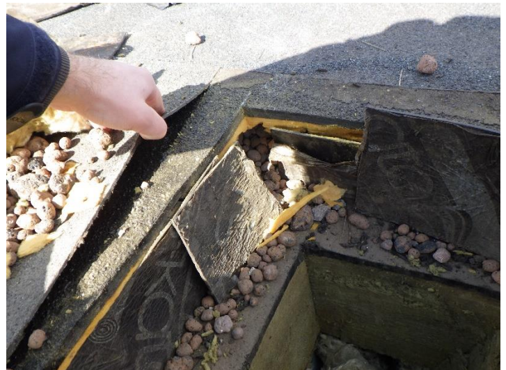
Kuva 50. Ylin bitumikermi oli irti alustastaan ja alle oli kertynyt kosteutta ja roskia
