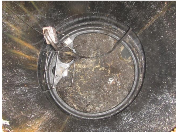
Kuva 13. Rasvanerotuskaivo on muovia.
