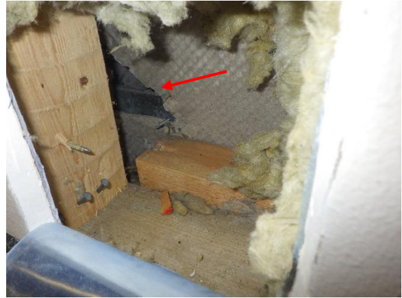
Kuva 39. Tilan 85 kohdalla tuulensuojalevystä oli irronnut paloja.
