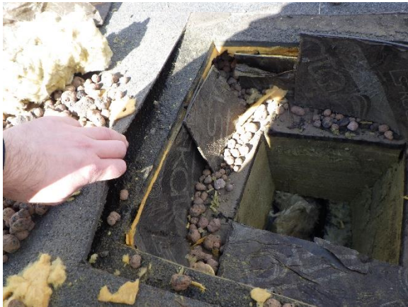
Kuva 74. Teknisentyön kohdalla päällimmäinen bitumikermi oli heikosti kiinni alustassaan
