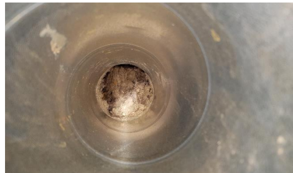
Kuva 87. Kanavan pätkä ilmanvaihtokonehuoneessa, jonka tarkoituksesta ei ole tietoa.
