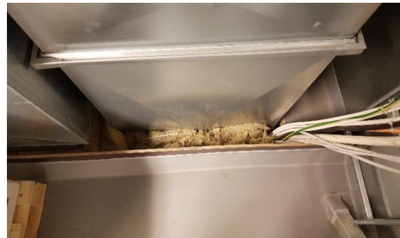
Kuva 91. Läpivienti ilmanvaihtokonehuoneessa, joka on pyritty tiivistämään lasivillalla.
