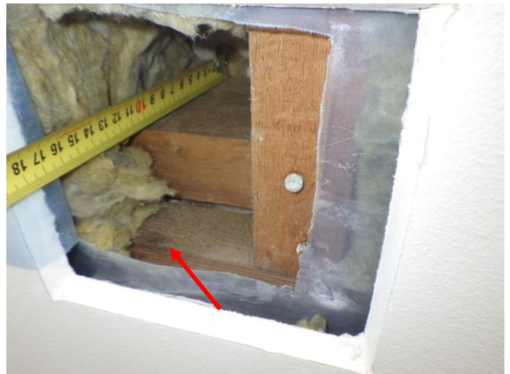
Kuva 46. Puukoolauksissa oli pientä kosteuden aiheuttamaa jälkeä
