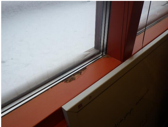
Kuva 33. Ikkunan karmissa sisäpuolella paikallinen lahovaurio
