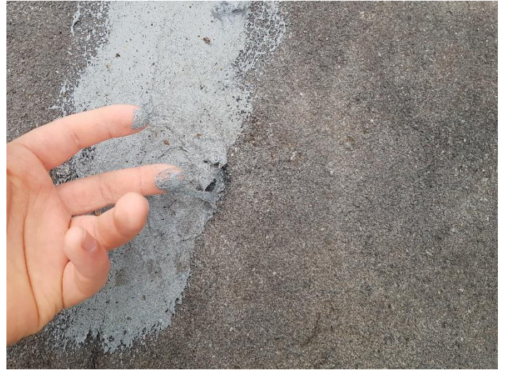
Kuva 56. Rakenneavauksen vieressä bitumikermien saumoja on tiivistetty liimamaisella massalla. Tutkimusten aikana massa oli tahmeaa.
