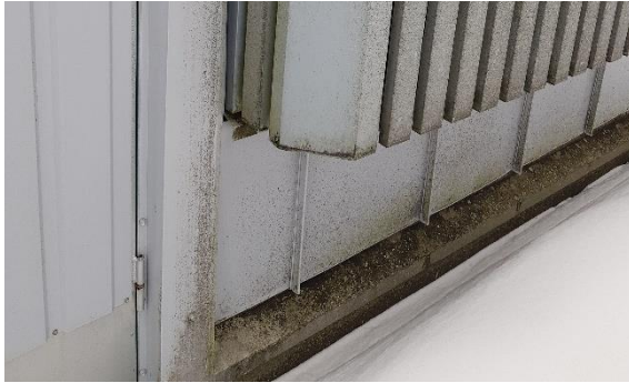
Kuva 126. Ilmanvaihtokonehuoneiden rakenteet alkavat sammaloitumaan.
