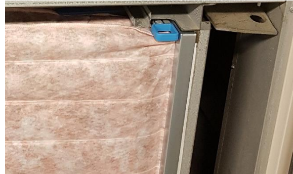
Kuva 95. Tuloilmasuodatin on tiiviisti paikoillaan.
