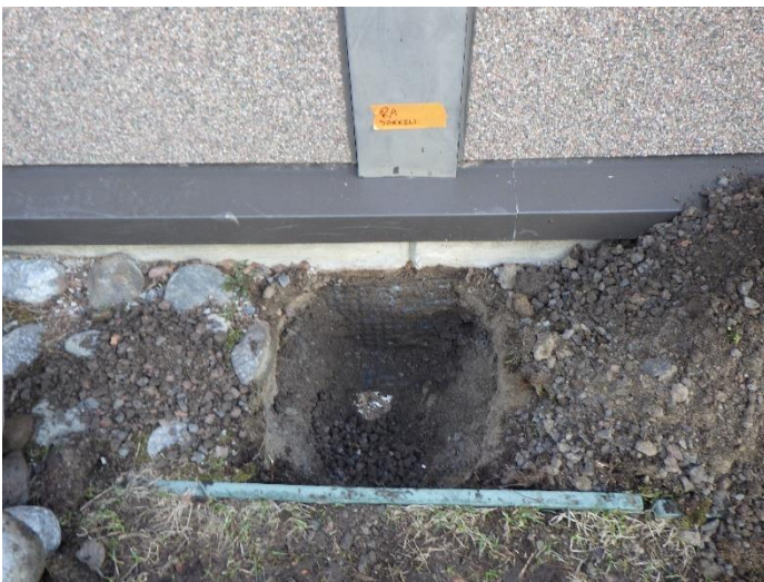
Kuva 17. Rakenneavauksen kohdalle tehtiin koekuoppa. Maa oli märkää. Perusmuurilevystä puuttui ylälistä. Perusmuurilevyn ja sokkelin välissä oli maa-ainesta
