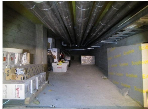
Kuva 17. Putkitunnelissa on roskia ja varastoitua tavaraa
