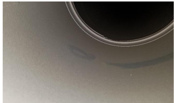
Kuva 111. Pölyinen tuloilman jakolaatikko.
