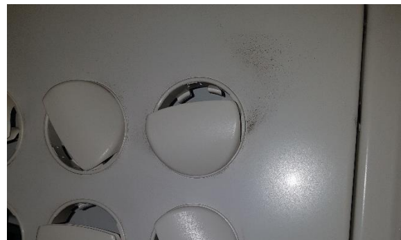
Kuva 121. Tuloilman päätelaite on pölyinen, pukuhuone 035.
