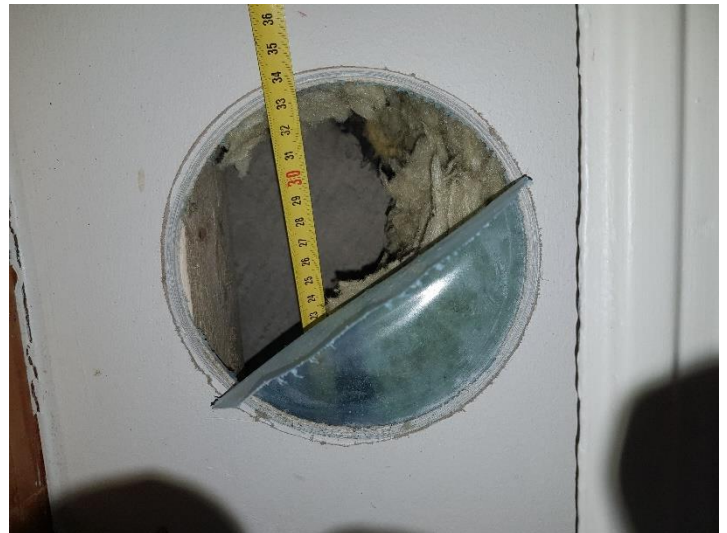
Kuva 34. Mineraalivilloissa oli vähäisiä ilmavuotojen aiheuttamia jälkiä
