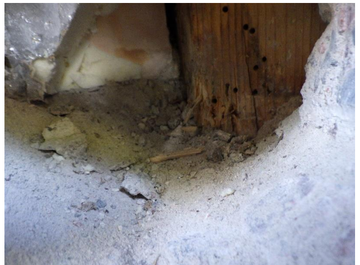
Kuva 18. Puupilarin alaosassa oli kosteuden aiheuttamia jälkiä
