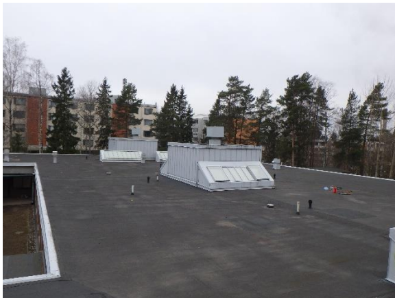
Kuva 60. Yleiskuvaa vesikatosta. Bitumikermien pinta on kulunut laikukkaaksi.
