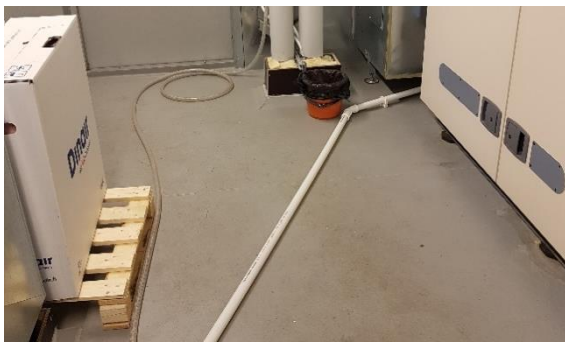
Kuva 92. Ilmanvaihtokoneen kondenssiveden poistoputki on johdettu lattian poikki.
