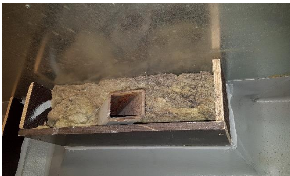
Kuva 86. Läpivienti ilmanvaihtokonehuoneessa, jonka tarkoituksesta ei ole tietoa.
