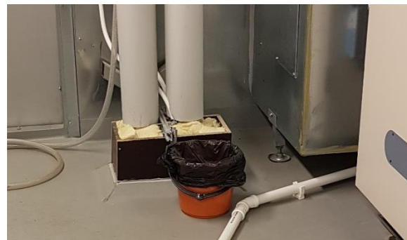
Kuva 93. Läpivienti ilmanvaihtokonehuoneessa. Läpivienti on pyritty tiivistämään lasivillalla. Tämän lisäksi on vesipiste lämpöjohtojen takana, läpiviennin välittömässä läheisyydessä.
