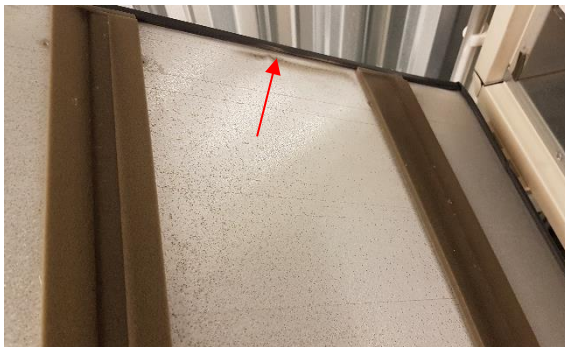
Kuva 108. Tuloilmakoneen TK05 huoltoluukussa on vuotovirtauksen jälkiä suodattimen kohdalla.
