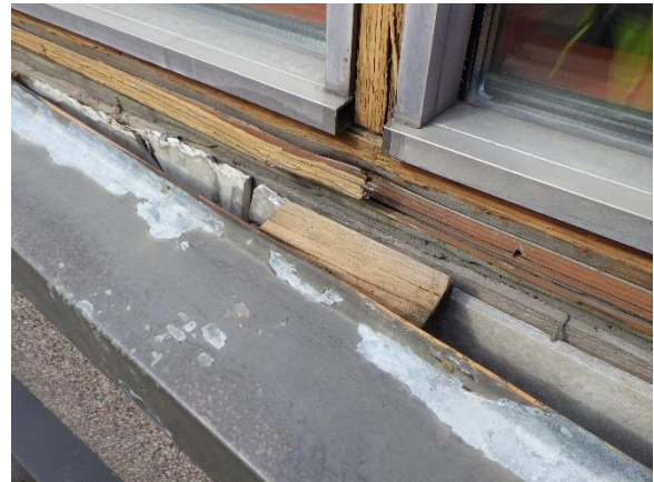
Kuva 34. Rakennuksen eteläpuolen ikkunat olivat huonokuntoiset ja pellitykset ovat irronneet
