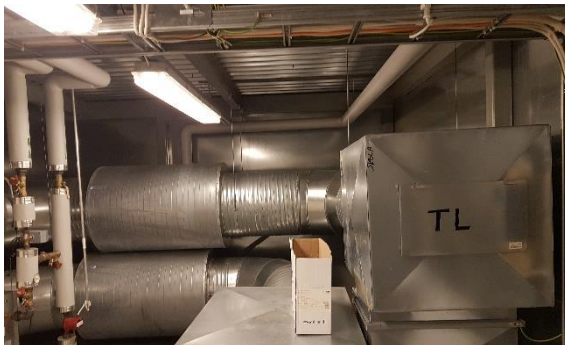
Kuva 90. Ilmanvaihtokonehuoneessa on äänenvaimentimet (vm. 2008) asennettu päällekkäin.
