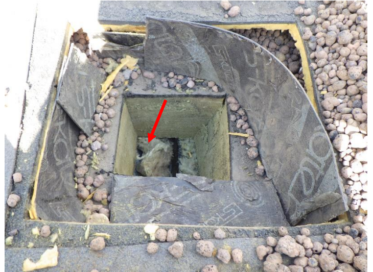
Kuva 52. Rakenteen alaosasta otettiin materiaalinäyte mikrobimäärittystä varten
