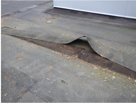
Kuva 64. Vesikaton on asennettu useita irtonaisia bitumikermikaistoja
