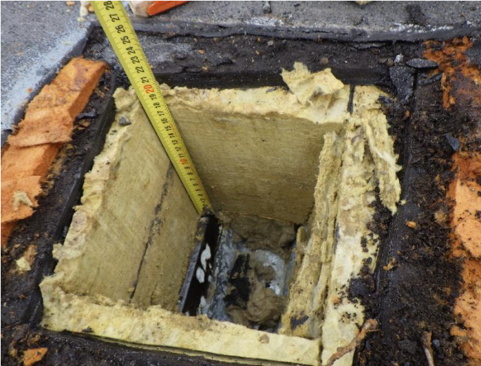
Kuva 55. Kuvaa rakenneavauksesta. Profiilipellin pohjalla olevasta mineraalivillasta otettiin materiaalinäyte mikrobimääritystä varten
