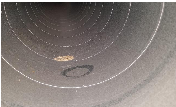
Kuva 114. Opetustilan 084 tuloilmakanava on pölyinen.
