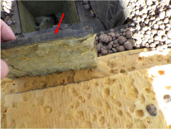
Kuva 51. Rakenneavauksen sisällä villakerrosten välissä oli pienellä alueella bitumia
