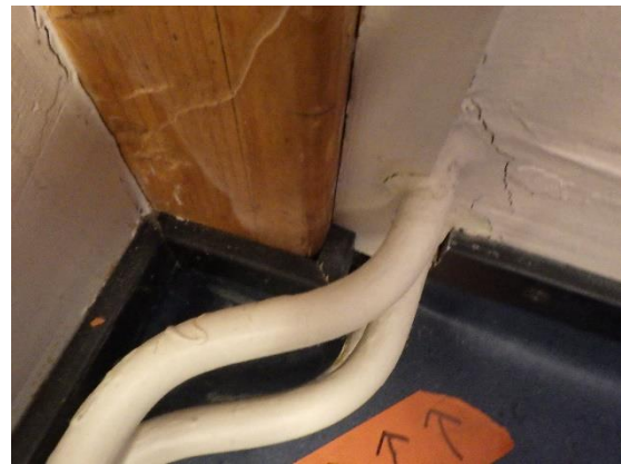
Kuva 30. Rakenneavausten perusteella vuoto johtuu puutteellisesti asennetusta radonkermistä
