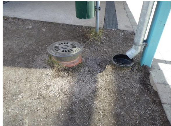
Kuva 14. Sadevesikaivo on maanpinnan yläpuolella.
