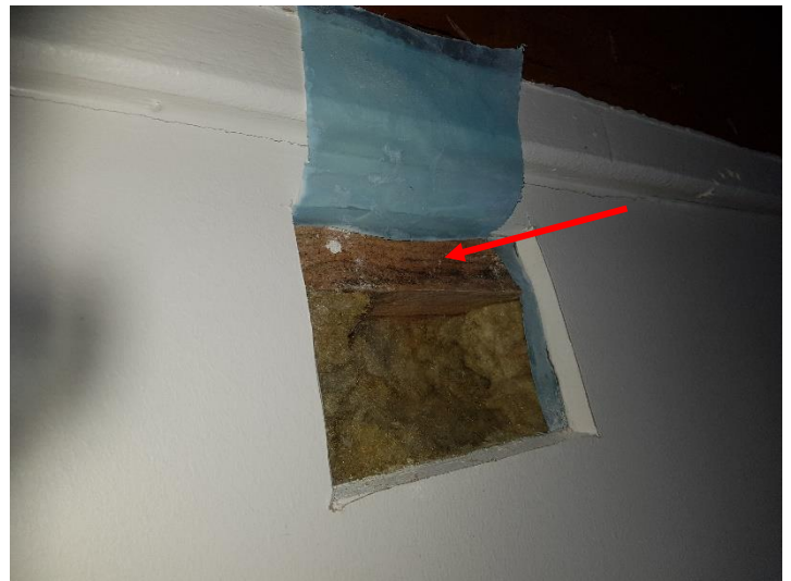
Kuva 30. Koolauksessa kosteuden aiheuttamia jälkiä ja mineraalivilloissa vähäisiä ilmavuotojen aiheuttamia jälkiä
