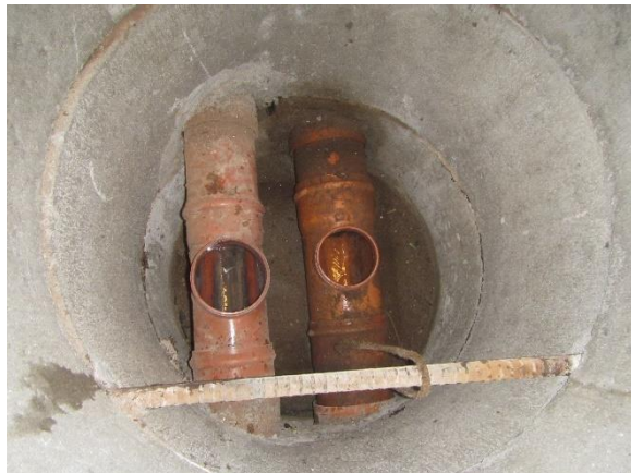
Kuva 15. Kuvassa pohjaviemäreiden tarkastuskaivo.
