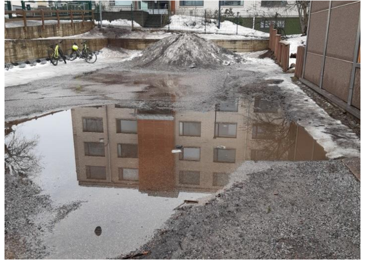
Kuva 28. Rakenneavauksen kohdalla sokkelin korkeus on matala ja piha-alueelle kertyy vettä. Valokuva on otettu 30.3.2021.
