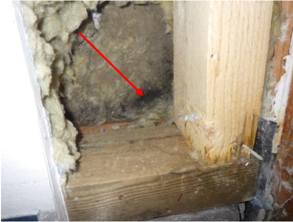
Kuva 38. Opettajan huoneessa (tila 10) tuulensuojalevyn sisäpinnassa oli jäätä ja rakenteissa oli kosteuden aiheuttamia jälkiä
