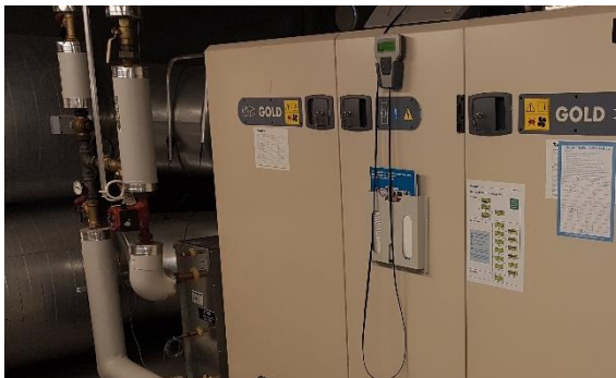
Kuva 96. Ilmanvaihtokonehuoneessa on äänen-vaimentimet (vm. 2008) asennettu päällekkäin.
