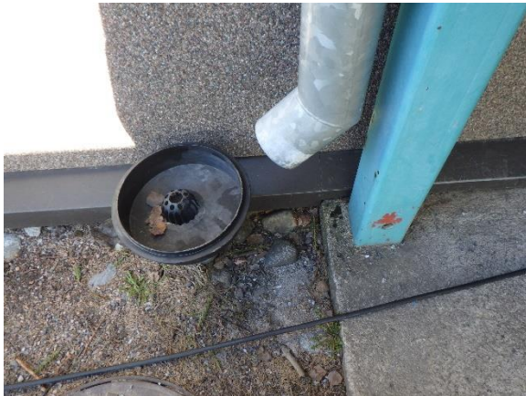
Kuva 13. Syöksytorven vedet ohjautuvat rakennuksen vierustalle.
