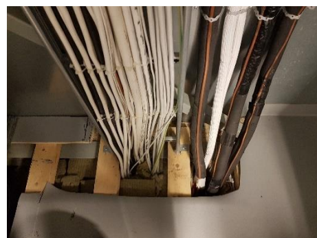
Kuva 105. Läpivienti ilmanvaihtokonehuoneessa, joka on epätiivis.
