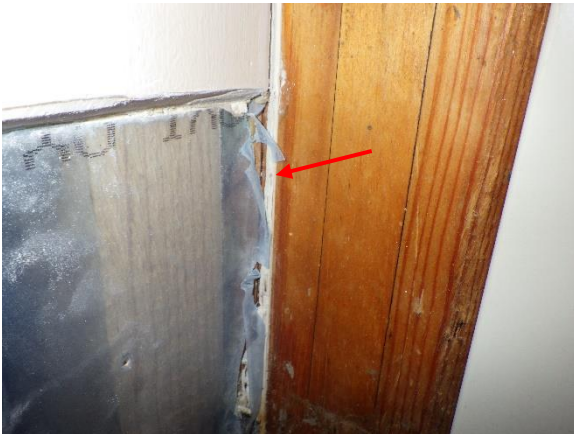
Kuva 40. Höyrinsulkumuovin ja ulkoseinän pystyrungon liitos puupilariin on epätiivis
