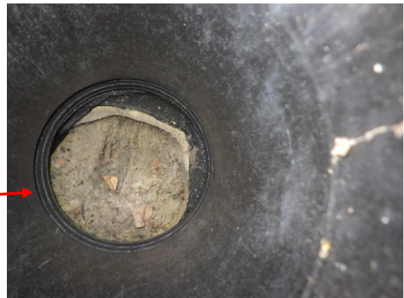
Kuva 63. Valokuva alipaineventtiilin sisältä. Yläpohjan kevytsora on korvattu mineraalivillalla.
