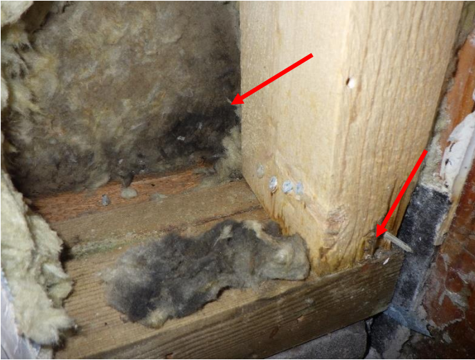
Kuva 21. Tuulensuojalevyn sisäpinnassa oli jätää ja koolauksissa kosteuden aiheuttamia jälkiä
