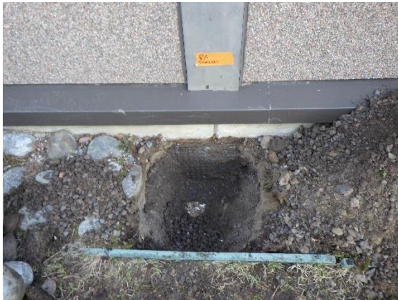
Kuva 44. Opettajien huoneen kohdalla tehty koe-kuoppa. Patolevystä puuttuu yläistä ja patolevyn taakse on kertynyt maa-ainesta.
