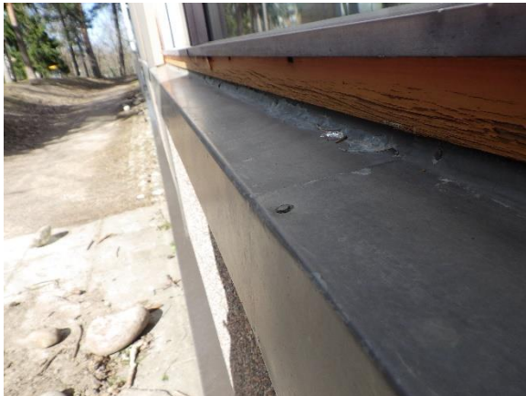
Kuva 31. Ikkunapellitykset kaatavat paikoin rakennusta kohti. Ikkunoiden karmien maalipinnat hilseilevät.
