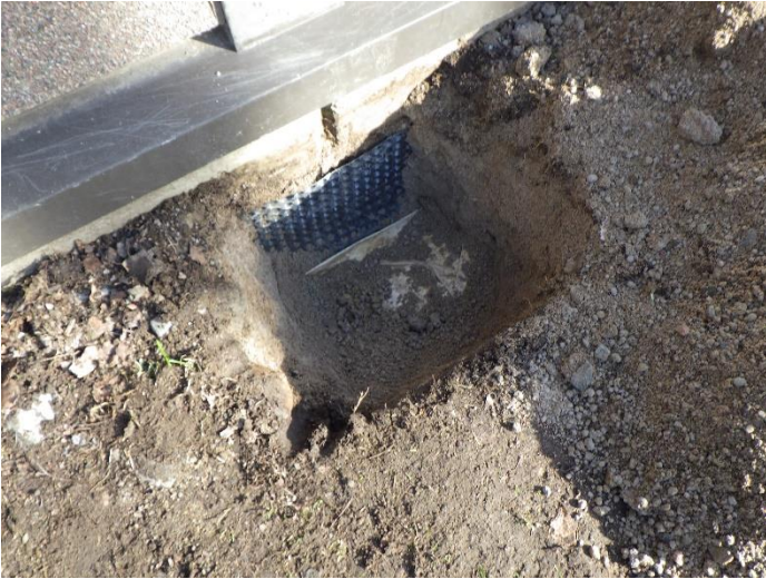
Kuva 27. Sokkelin viereen tehtiin koekuoppa. Sokkelin vierusta on täytetty hienolla hiekalla. Perusmuurilevyn ja sokkelin välissä oli maa-ainesta.
