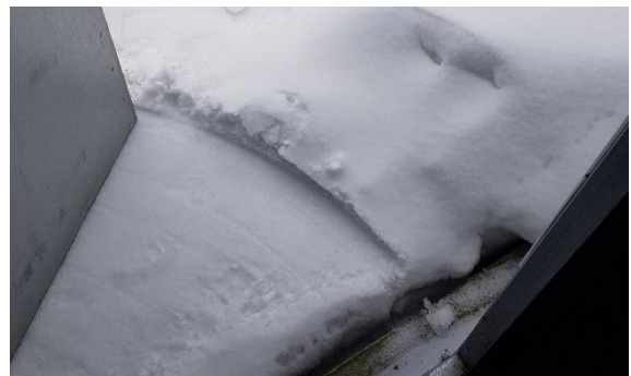
Kuva 129. Lumi haittaa katolla kulkua ilmanvaihtokonehuoneeseen.
