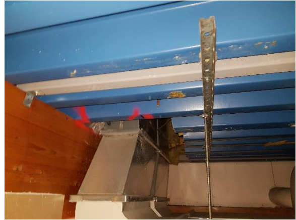
Kuva 65. Alaslaskettu katto on kannakoitu puupalkkien väliin asennettuihin teräksiin. Kuvassa näkyy myös IV-konehuoneisiin johtavat epätiivit läpiviennit.
