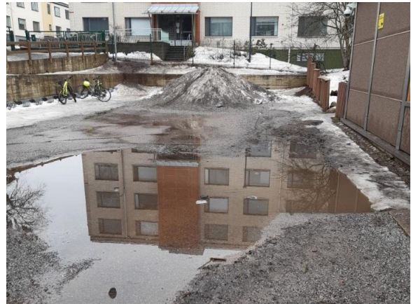
Kuva 10. Eteläisivulla sokkelin korkeus on matala ja piha-alueelle kertyy vettä. Valokuva on otettu 30.3.2021.
