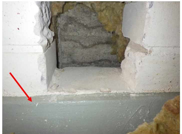
Kuva 40. Betonisesta jalkalistasta otetussa näytteessä ei todettu asbestia
