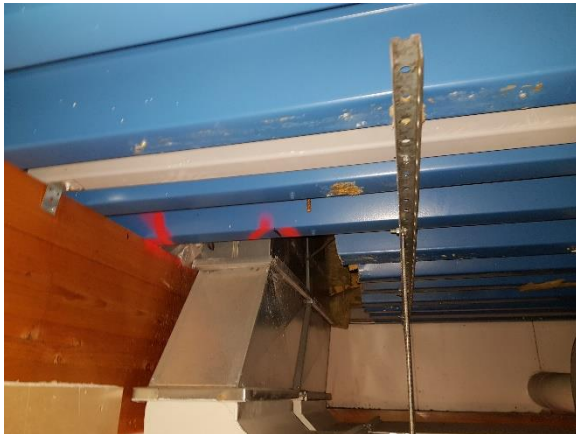
Kuva 52. Ruokailu 90 kohdalla olevan IV-konehuoneen talotekniikan läpiviennit
