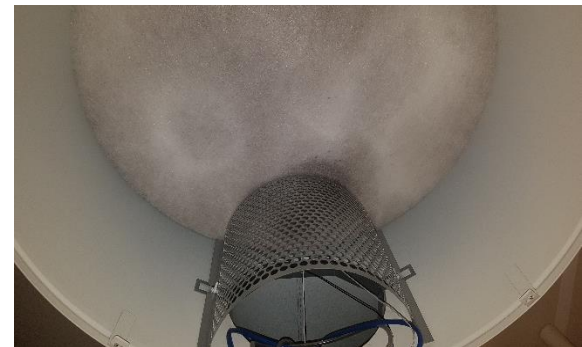
Kuva 117. Tuloilman päätelaite on pölyinen, käytävä 021.
