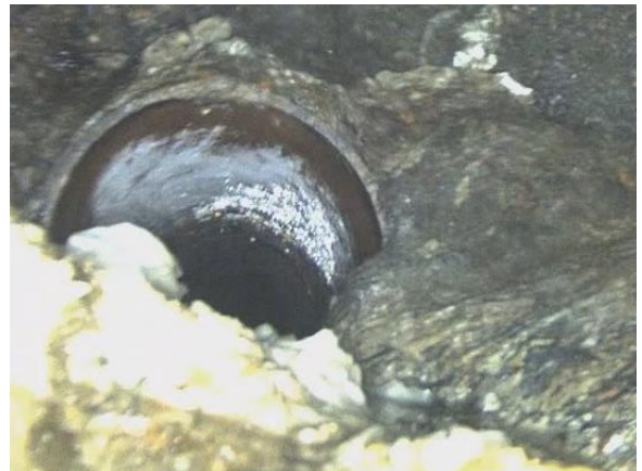
Kuva 16. Tarkastuskaivoissa havaittiin suuria jätekertymiä.
