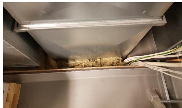
Kuva 99. Läpivienti on pyritty tiivistämään lasivillalla. Kaapelinipun läpivienti on epätiivis.
