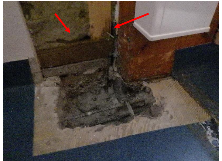
Kuva 20. Mineraalivilloissa oli ilmavuotojen ja kosteuden aiheuttamia tummentumia
