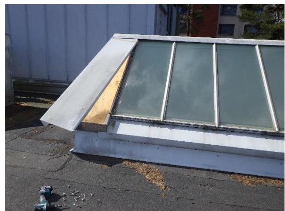
Kuva 77. Tilan ruokailu 44 kohdalla olevan kattoikkunan puurakenteissa oli vähäistä kosteuden aiheuttamaa jälkeä.
