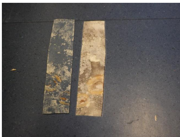
Kuva 27. Tilan 10 muovimaton alla oli voimakas mikrobiperäinen haju ja näkyvää mikrobikasvua.
