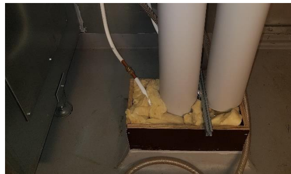
Kuva 103. Läpivienti ilmanvaihtokonehuoneessa, joka on pyritty tiivistämään lasivillalla.
