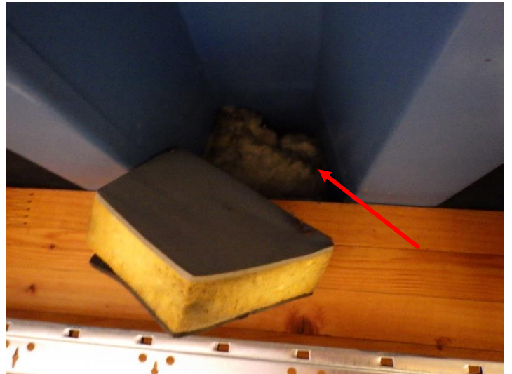
Kuva 12. Profiilipeltien ja puupalkkien liitoskohtia oli tiivistetty vaahtomuovilla. Taustalla olevissa mineraalivilloissa oli runsaasti ilmavuotojen aiheuttamaa tummentumaa
