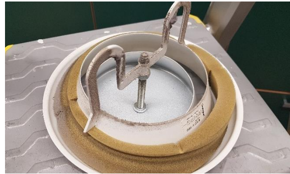
Kuva 119. Tuloilman päätelaite on pölyinen, Opetustila 041.
