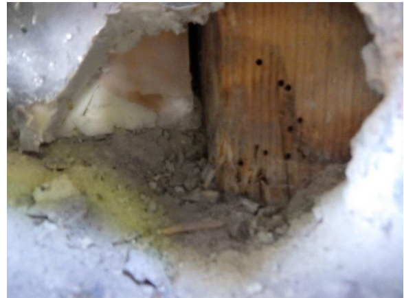
Kuva 45. Opettajien huoneen kohdalla puupilarin alaosassa pientä kosteuden aiheuttamaa jälkeä. Puupiikimittarilla mitattuna kosteus on 20 paino-%.
