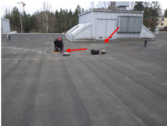
Kuva 70. Musiikkiluokan kohdalla vesikattoa on korvattu liimamaisella massalla. Alueet merkitty nuolilla.
