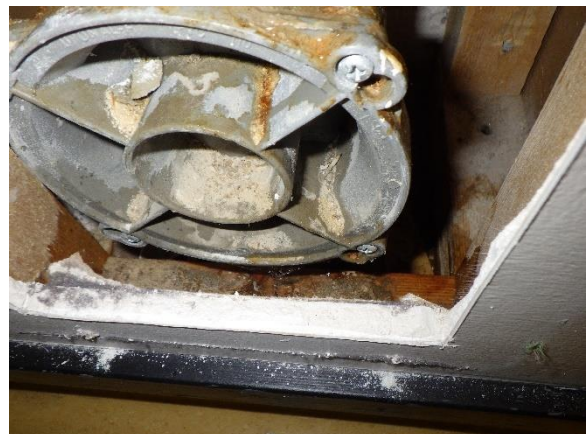
Kuva 69. Musiikkiluokan 78 vesikaton vedenpoistojärjestelmä vuotaa
