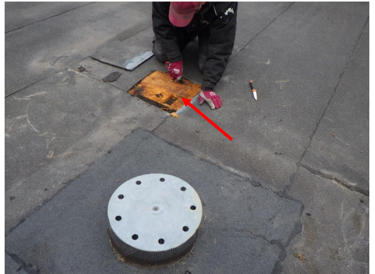
Kuva 54. Bitumikermien välissä oleva mineraalivilla oli vesimärkä.
