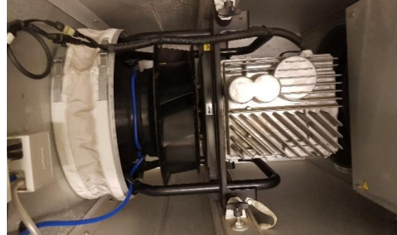
Kuva 107. Tuloilmapuhallin TK05 on aistinvaraisesti arvioituna puhdas.
