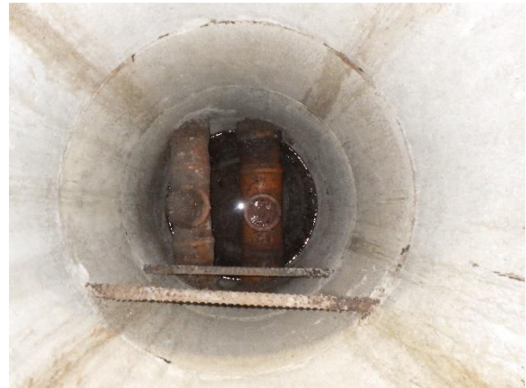
Kuva 19. Tarkastuskaivon pohjalla on vettä
