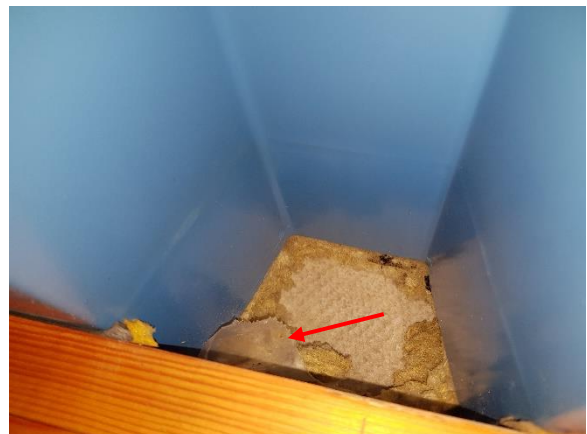
Kuva 43. Ulkoseinän ja yläpohjan liitoskohdassa ulkoseinän höyrinsulkumuovi oli paikoin revennyt. Taustalla näkyy valokuvauksen ajaksi poistettua mineraalivillaa ja ulkoseinän tuulensuojalevy
