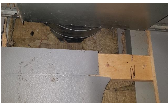
Kuva 104. Korottamaton läpivienti ilmanvaihtokonehuoneessa.
