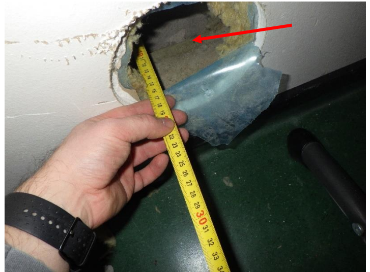
Kuva 32. Puurungossa oli pieniä kosteuden aiheuttamia jälkiä
