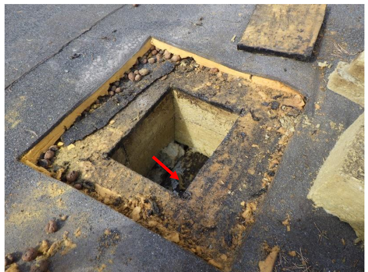
Kuva 58. Yläpohjan alapinnasta otettiin materiaalinäyte mikrobimääritystä varten
