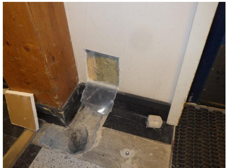
Kuva 16. Alapohjan radonkermi oli nostettu pilari vasten
