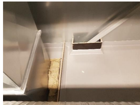
Kuva 97. Läpivienti ilmanvaihtokonehuoneessa, joka on pyritty tiivistämään lasivillalla.
