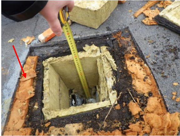
Kuva 72. Musiikkiluokan vesikaton rakenneavauksessa ylempi mineraalivilla oli märkää.
