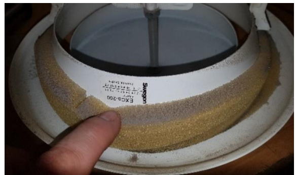
Kuva 115. Poistoilman päätelaitteet ovat pölyiset.
