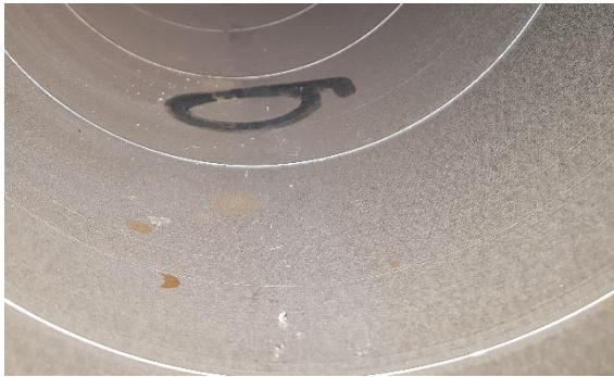
Kuva 118. Opetustila 085 tuloilmakanava on pölyinen ja kanavassa on irtolikaa.
