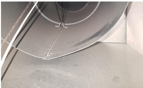
Kuva 120. Pukuhuone 035 tuloilmakanava on pölyinen ja kanavassa on irtolikaa.
