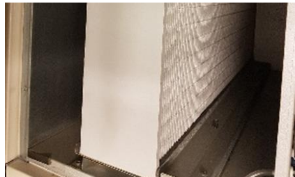
Kuva 109. Tuloilmasuodattimena on kennosuodatin.
