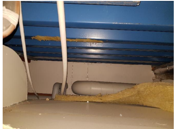
Kuva 67. Alaslasketun katon päällä on paikoin irtonaista mineraalivillaa
