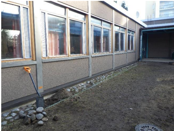
Kuva 9. Eteläisivulla sokkelin korkeus on melko matala ja maanpinta on lähes lattiapinnan tasolla. Maanpinta kallistuu paikoin rakennusta kohti.
