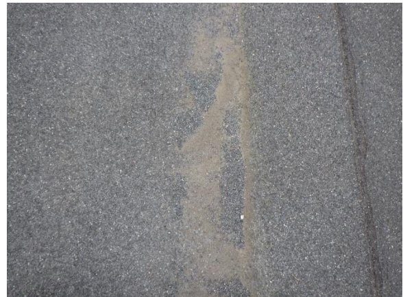
Kuva 61. Lähikuvaa kuluneesta bitumikermien pinnasta.
