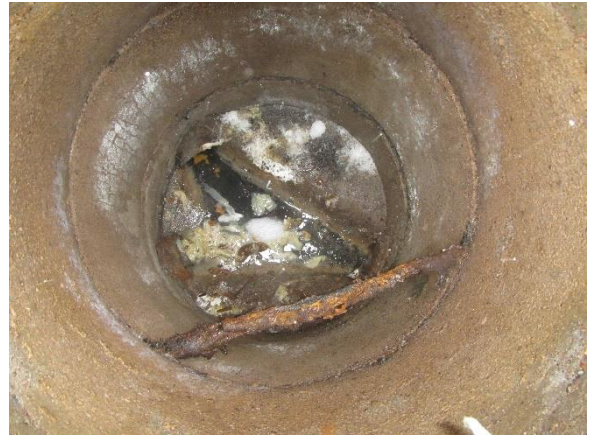
Kuva 14. Tarkastuskaivojen pohjalla on runsaasti jätekertymiä.
