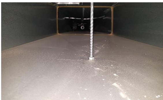
Kuva 124. Tilan 43 tuloilmakanavaa puhdistusluukun kautta. Pinta-pölynkoostumusnäyte 3. Pääasiallinen koostumus metallipölyä ja kiviainestyyppistä pölyä.
