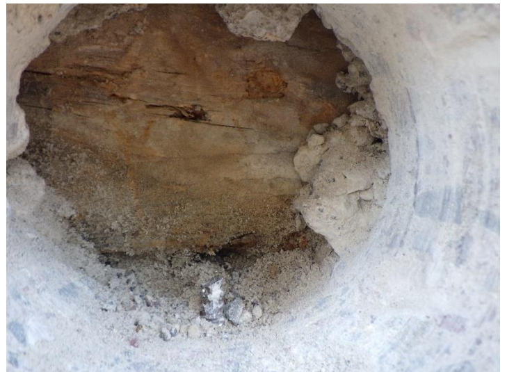
Kuva 26. Sokkelin halkaisussa oleva lauta oli lahovaurioitunut
