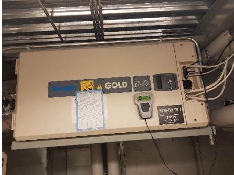
Kuva 106. Tuloilmakone TK05 on samassa konehuoneessa ilmanvaihtokoneen TK/PK04 kanssa.
