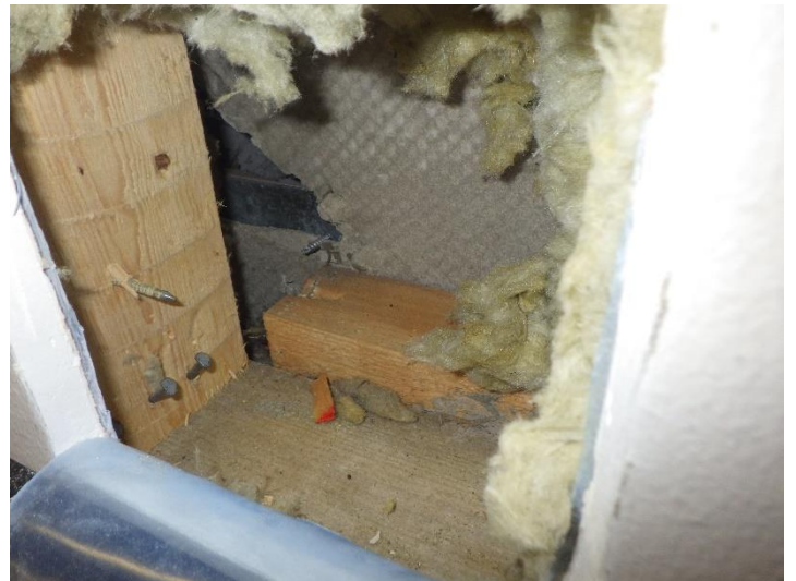
Kuva 8. Rakenneavauksen kohdalla tuulensuojalevystä puuttui paloja
