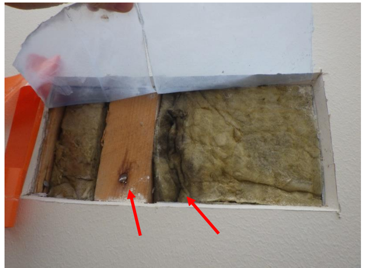
Kuva 48. Mineraalivilloissa oli runsaasti ilmavuotojen aiheuttamia jälkiä ja puurungossa vähäisiä kosteuden aiheuttamia jälkiä
