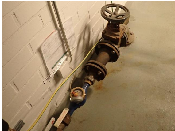
Kuva 1. Tonttivesijohto ja vesimittari ovat lämmönjakohuoneessa.
