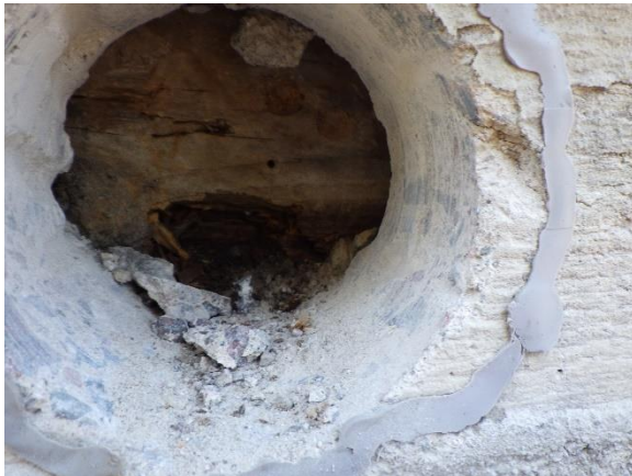
Kuva 46. Tilan 117 kohdalla puupilarin alaosa ja sen edessä oleva lauta olivat lahovaurioituneet. Pilarin alaosan kosteus oli yli 50 paino-%.
