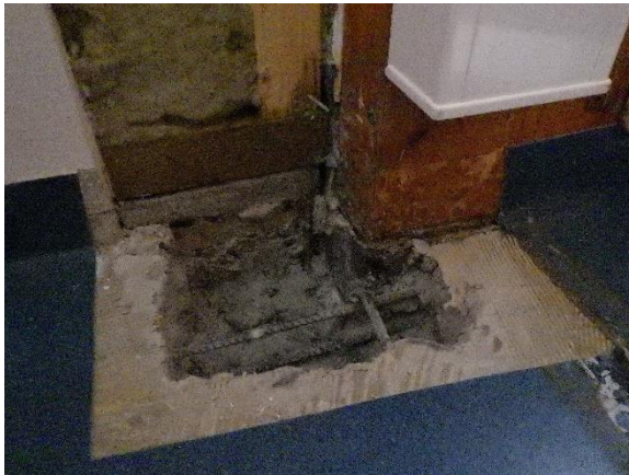
Kuva 20. Tilan 10 pilarin alaosan rakenneavaus. Ra- kenneavauksen kohdalla oli 100 mm betonia, bitumi- kermi ja 100 mm solupolystyreeniä. Bitumikermi ylösnoston liitoskohta oli epätiivis
