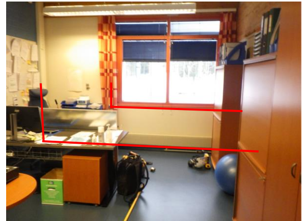
Kuva 49. Punaisella viivalla on havaittu alueet, joissa havaittiin vuotoilmareittejä. Kuvaan ei ole merkitty yksittäisiä reikiä sisäverhouslevyissä.
