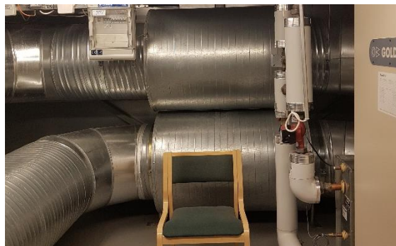
Kuva 102. Ilmanvaihtokonehuoneessa on äänenvaimentimet (vm. 2008) asennettu päällekkäin.
