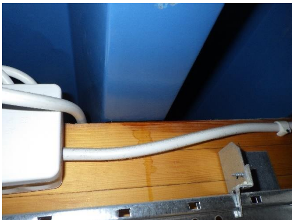
Kuva 68. Musiikkiluokan 78 yläpohjan vesivuotokohta.
