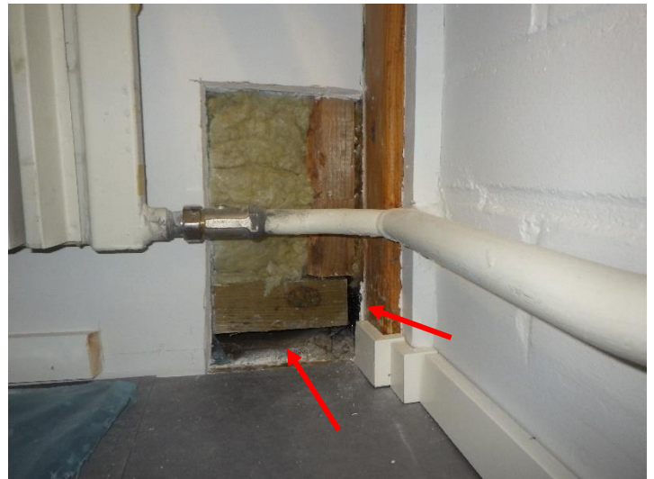
Kuva 2. Alaohjauspuun ja kevytsoraharkon välissä on lämmöneristämätön rako
