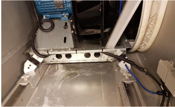
Kuva 88. Tuloilmapuhallin TK02 on hieman pölyinen ja kammiossa on vanhoja kosteusjälkiä.
