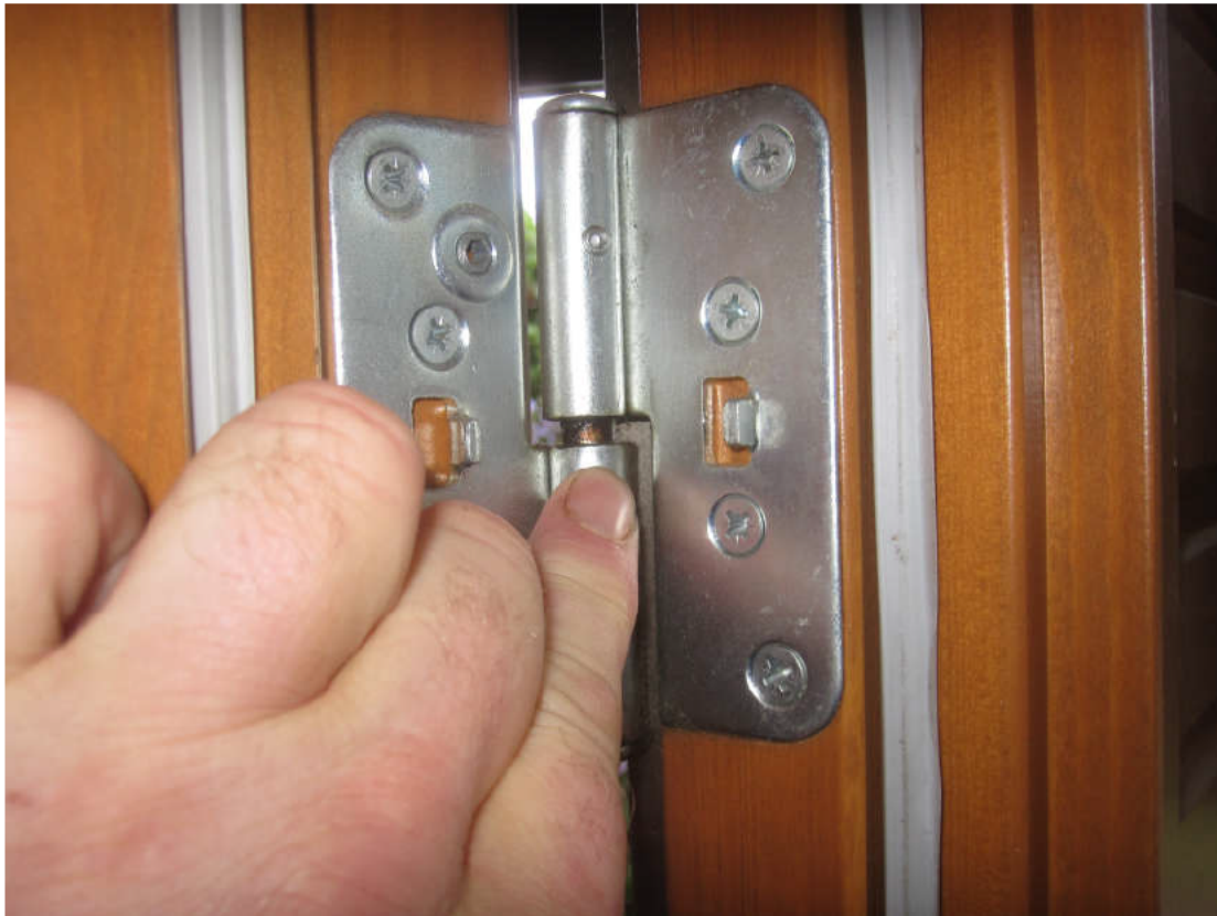
Kuva 3. Säädetty pääoven sarana (loppukatselmus 20.8.2019)
